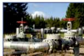
Контроль состояния задвижек
