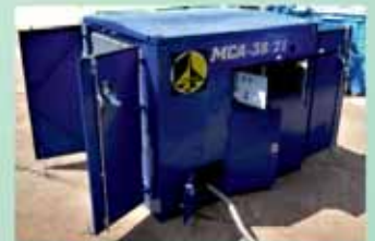
Газоразделительный блок азотной установки
