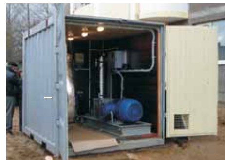
Фото 2. Общий вид БМТП-55.
