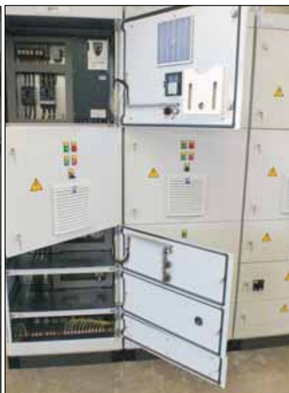
Шкафы Rittal АСУ ТП в цеху сборки НКУ
